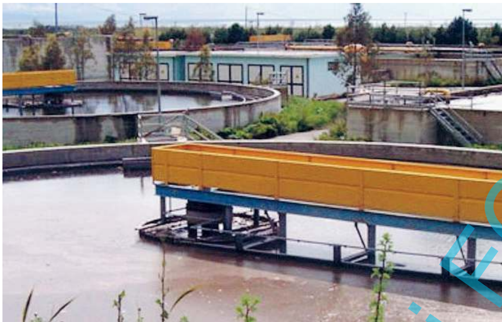
L'impianto. Nel depuratore di Nocera finiscono i liquami di Amantea e Belmonte, comuni che secondo il sindaco Gigliotti, non pagano le loro quote per la gestione
